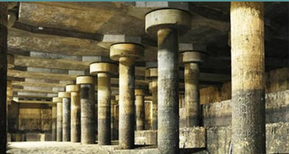
Tanques de tormentas
